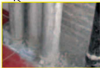
Tuyaux d'évacuation des eaux usées
