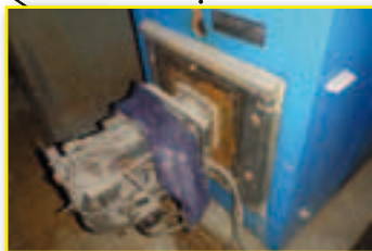
Joint de brûleur chaudière
