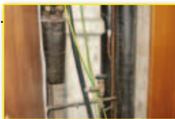
Tuyau de ventilation
